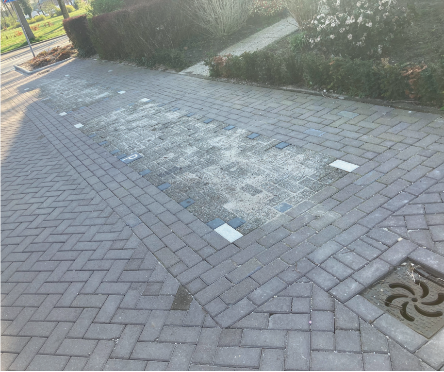
Figuur 4. De nieuwe situatie in Griffiersveld: parkeerplaatsen, ingelegd met een binnenvlak van gebruikte betonstraatstenen en een straatkolk om hemelwater te infiltreren in de ondergrond.
