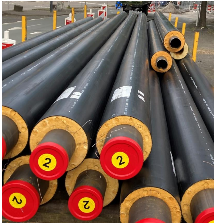
Figuur 15: Warmtenetten kunnen een belangrijke rol in de energietransitie vervullen.
